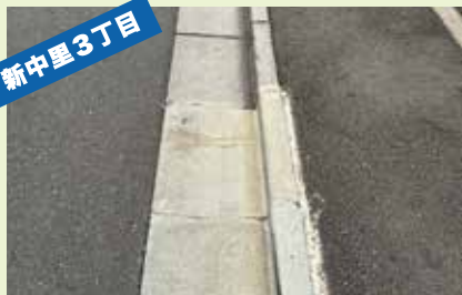
新中里3丁目 道路陥没・縁石の修繕
